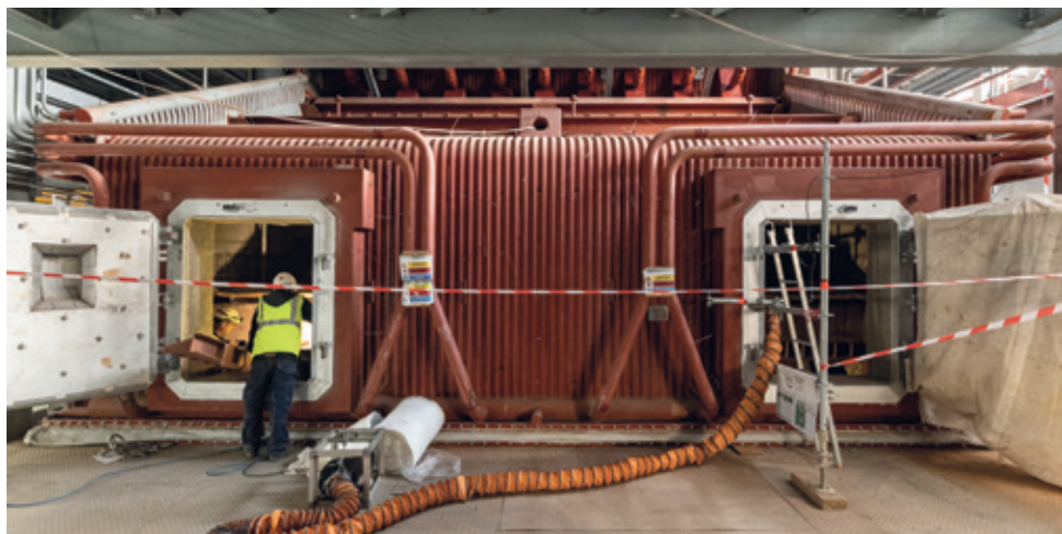
❶ Porte d'accès à l'intérieur du four au niveau du plan de grilles.
